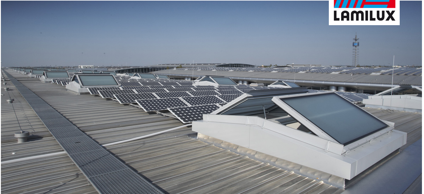
Двустворчатые люки дымоудаления на выставочном зале в мюнхене, германия
